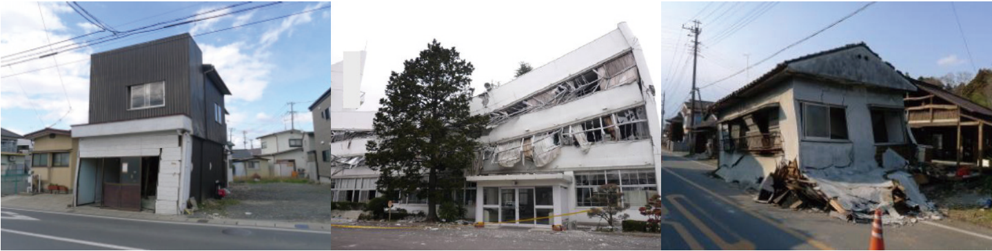
写 3-2-3 地震による被害
